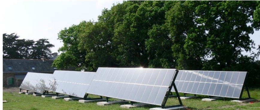
Site insulaire- installation photovoltaïque de 6 kWc – stockage batterie – île de Gavrinis (56)
