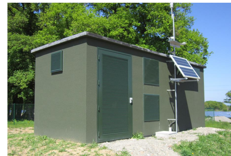
Photographie 3 : Poste transformateur (source : ENCIS Environnement)
