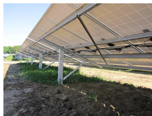
Photographie 2 : Modules photovoltaïques (source : ENCIS Environnement)
