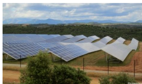
Photographie 1 : Exemple d'installation photovoltaïque au sol
