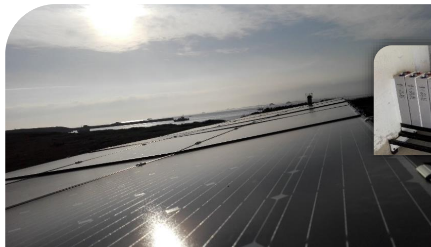
Installation autonome photovoltaïque de 5,25 kWc - Île de Lédénez Vraz - Archipel de Molène (29)
