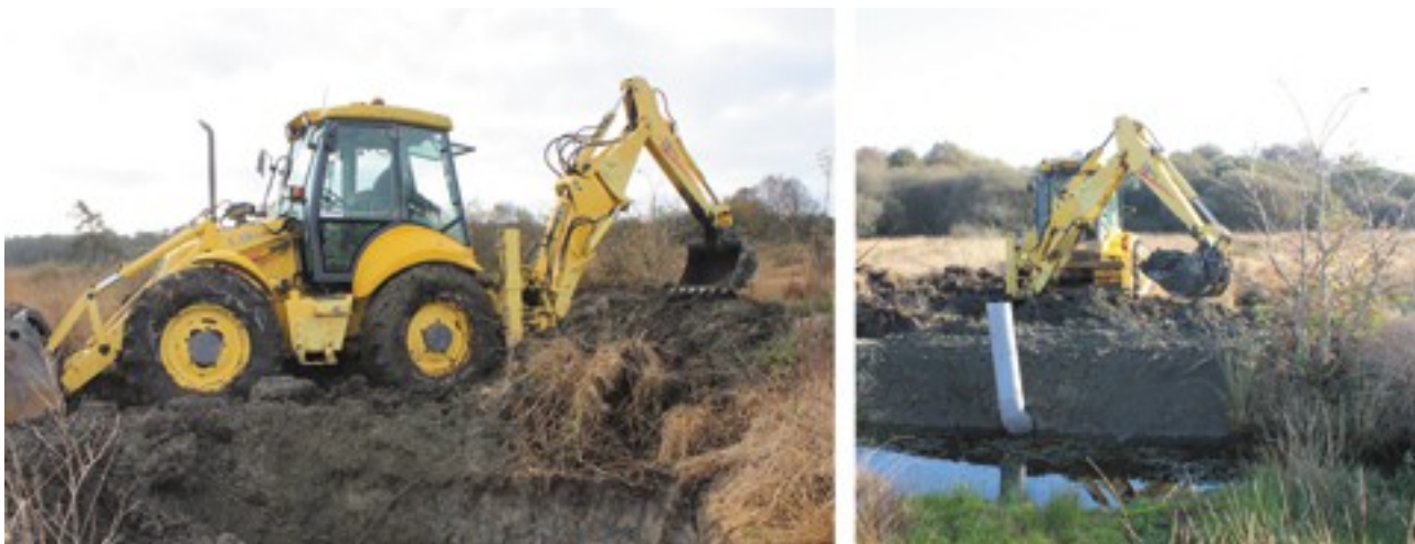
Réparation de l'ouvrage fuyard avec un tracto-pelle – Mise en place du tuyau PVC diamètre 200 mm
