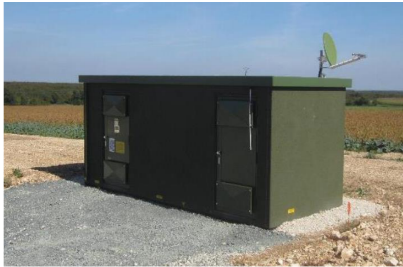
Un exemple de poste de livraison électrique
