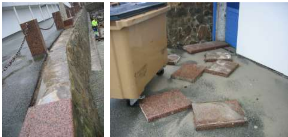
Fig. 79. Dégâts sur le dallage devant le centre nautique de Trestraou (tempête du 10 mars 2008)
