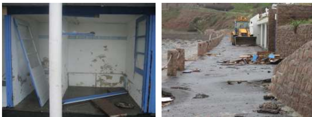
Fig. 80. Dégâts sur les cabines de Trestraou (tempête du 10 mars 2008)
