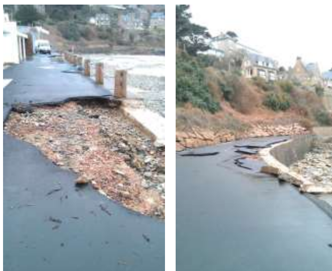
Fig. 83. Dégâts sur la digue de Trestrignel dus à la tempête du 3 mars 2014
