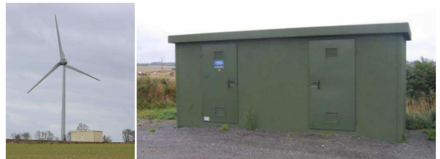
Photo 120 : exemples de poste de livraison électrique
