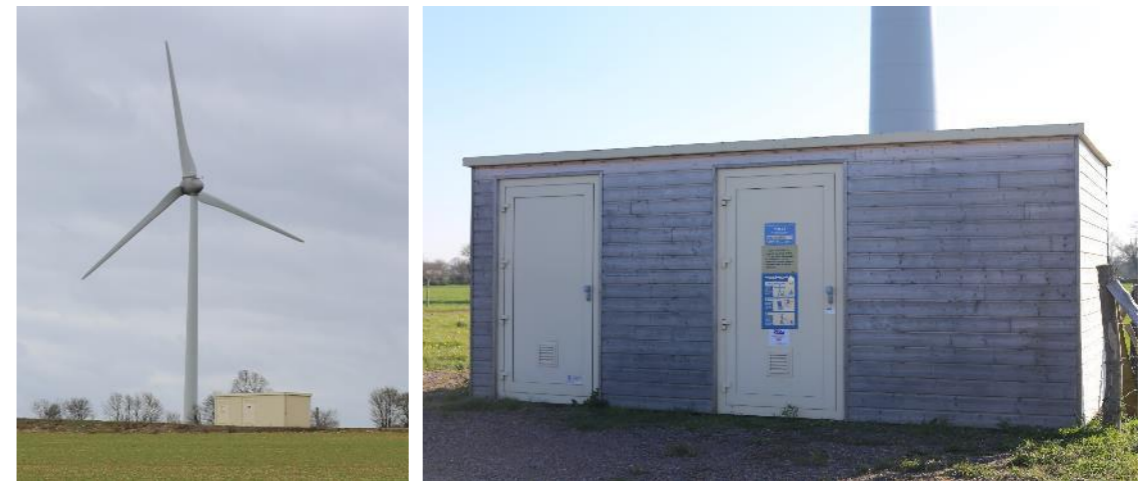
Figure 15 : exemples de poste de livraison électrique
