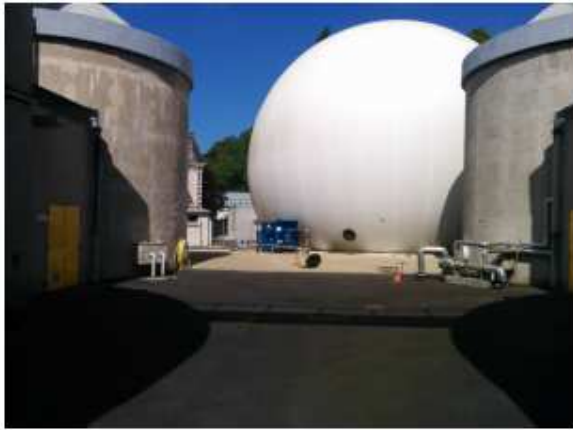
Digesteurs secondaires et gazomètre
