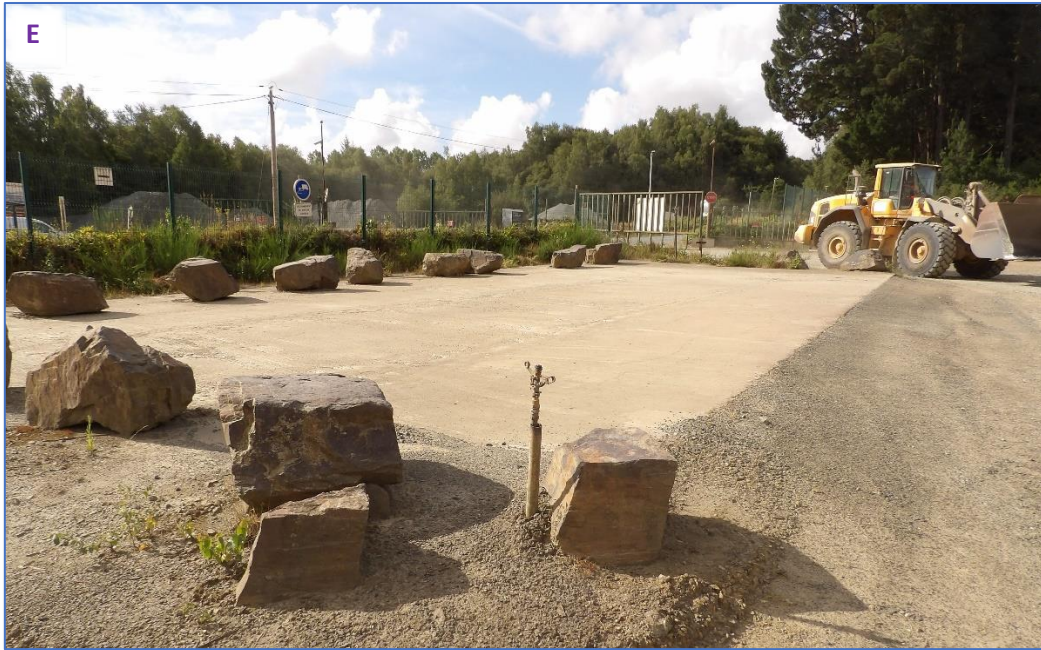
Fig. 18 : Aire étanche (et dispositif pour l'aspersion des pistes au premier plan)
