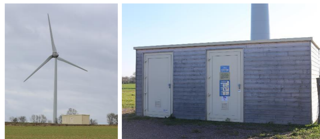
Photo 10 : Exemples de poste de livraison électrique
