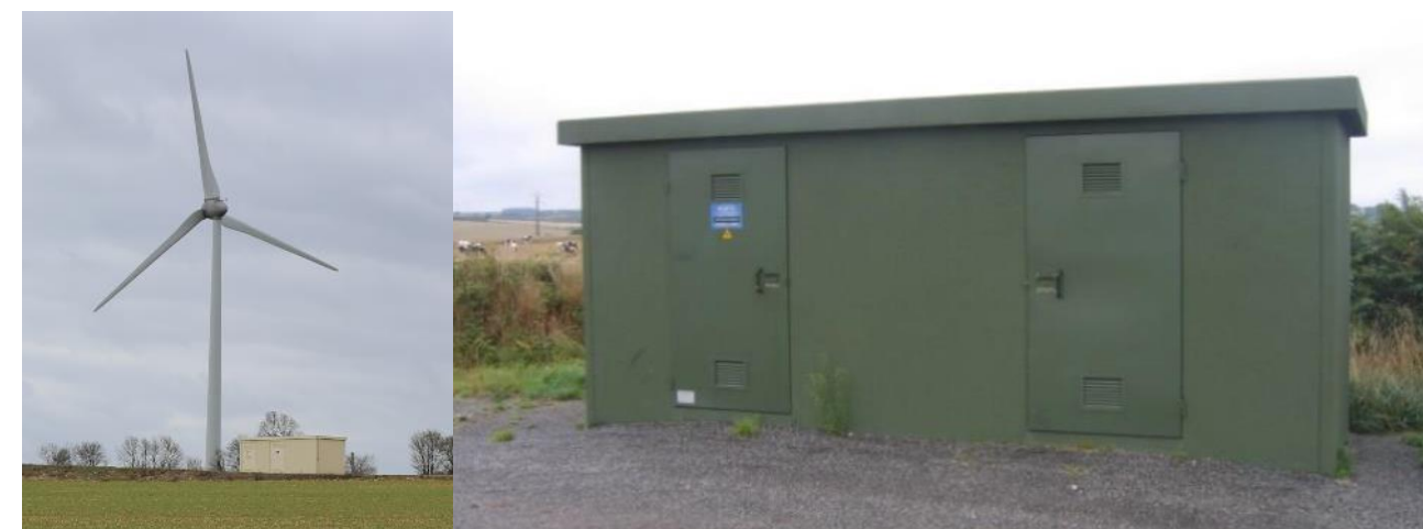
Photo 5 : exemples de poste de livraison électrique
