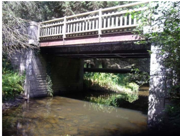
Photographie 4 : OH de franchissement du Petit Doré au nord de la RN164 vue de l'aval
