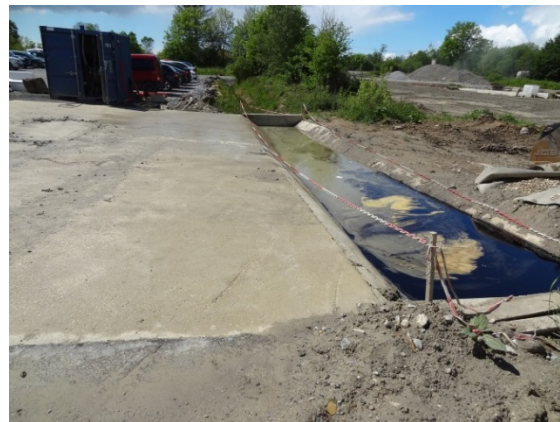
Photographie 19 : Exemple de bassin de stockage de produits polluants, d'aire de lavage de goulotte de toupies et d'aire de lavage d'engins équipée en sortie d'un débourbeur-déshuileur (© Egis / D. Ferreira)
