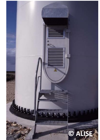
Photo 30 : Transformateur électrique intégré au mât de l'éolienne
