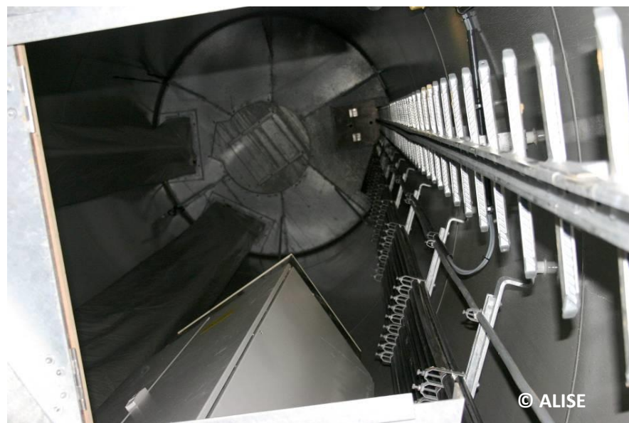
Photo 28 : Intérieur du mât d'une éolienne (échelle d'accès)
