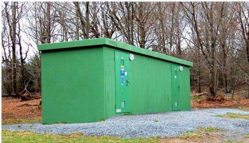
Photo 5 : Un exemple de poste de livraison électrique
