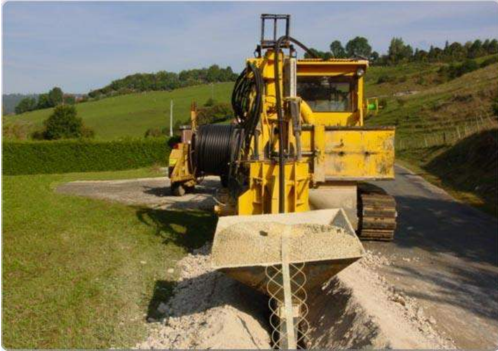
Photo 4 : La pose d'un câble souterrain depuis le poste de livraison jusqu'au réseau électrique national
