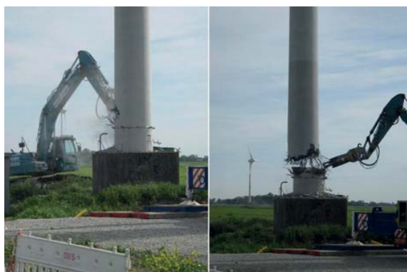
Figure 8: Excavateur de démolition en action sur une petite éolienne (pendant les travaux de démontage le mât est retenu par une grue)
