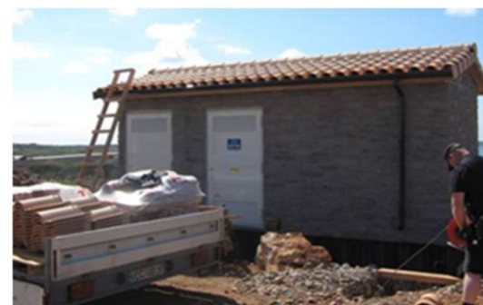
Figure 5: Photo d'un poste de livraison
