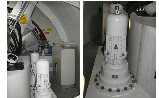
Nacelle d'éolienne ENERCON en service depuis 15 ans
