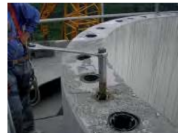
Figure 12: Repassage de filetages endommagés
