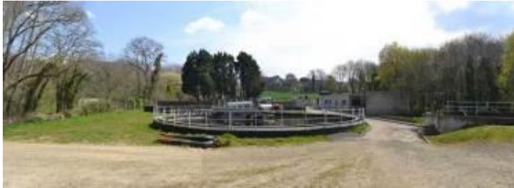
Photo n° 01 : les installations sont constituées de bassins qui sont peu visibles de loin.
