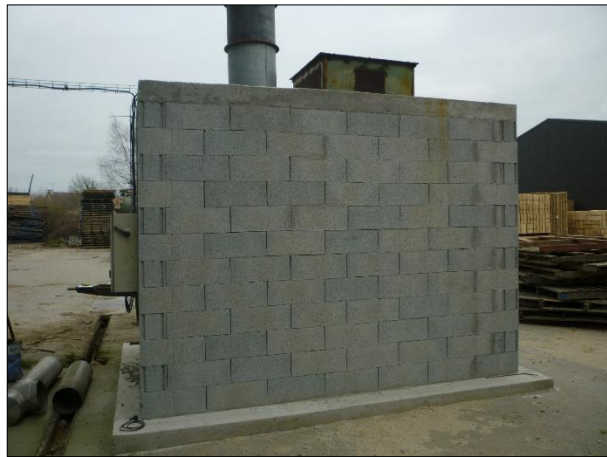
Figure 28 : Chaudière bois installée
